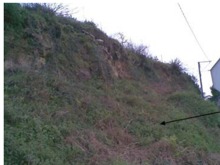
Derrubios a pie de talud
